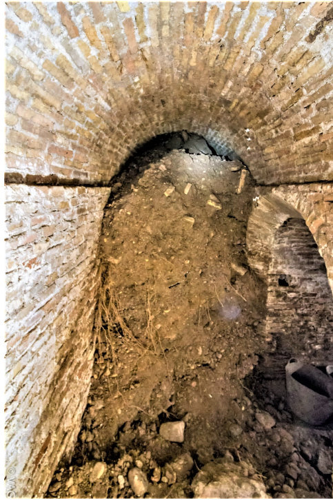
Lám. IV.- Cúmulo de escombros en la entrada al refugio antiaéreo por la Plaza Vieja.
