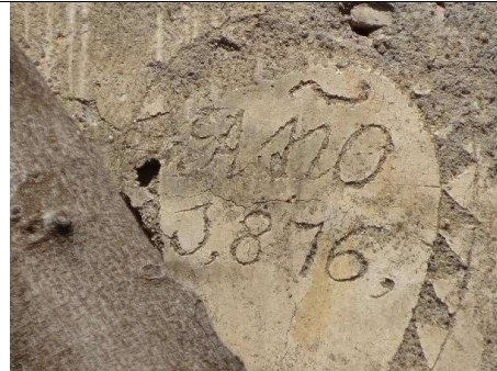
Fig.7. Detalle del enfoscado exterior de la trasera de uno de los edificios cercanos (Lagunillas 46 o 48).
