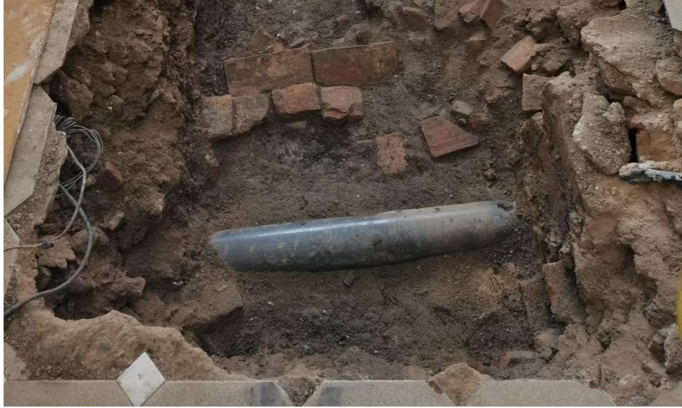
Lámina 7. Afección en Sondeo 2.
