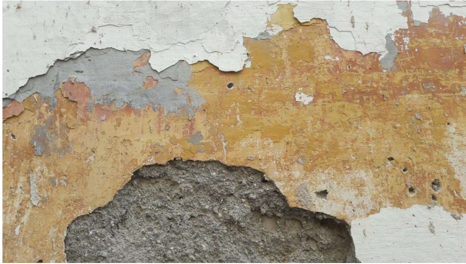
Lámina 7. Detalle de la superposición de capas de pintura en la fachada
