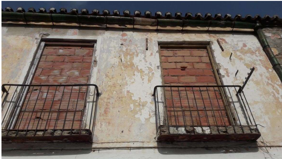
Lámina 17. Vista de la planta superior con las capas de cal descascarilladas
