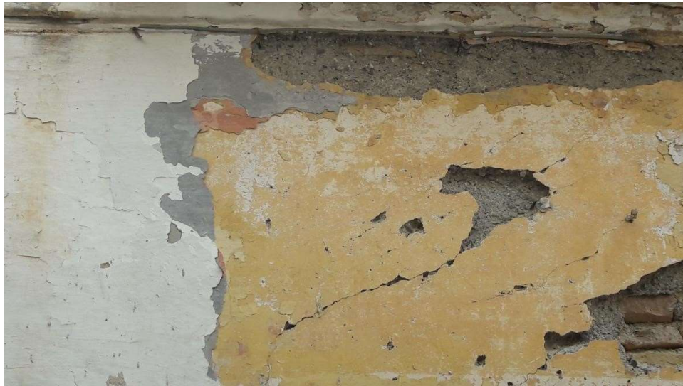
Lámina 19. Planta baja de la fachada con pérdida de enlucido y de capas de pintura
