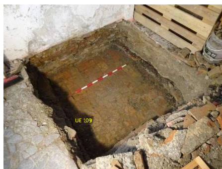
Fig. 2. Vista de la segunda fase de pavimentación. Solería de mazarías rectangulares colocados en espiga (UE 109). Se puede observar su mal estado.
