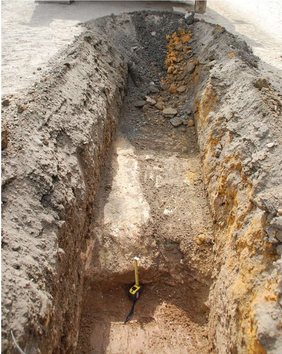
Lám. 4: Alineación de la unidad 10 con respecto a la zanja de drenaje
