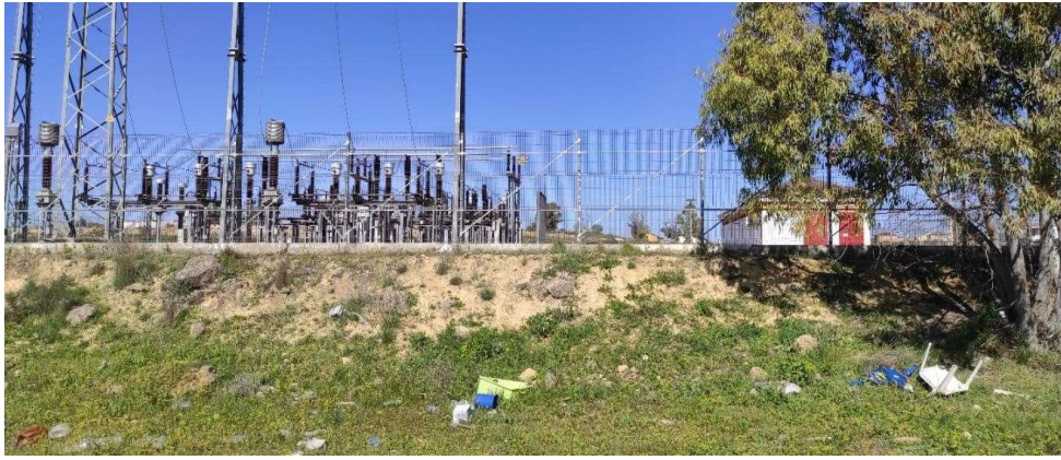
Fig. 23. Detalle de la subestación
