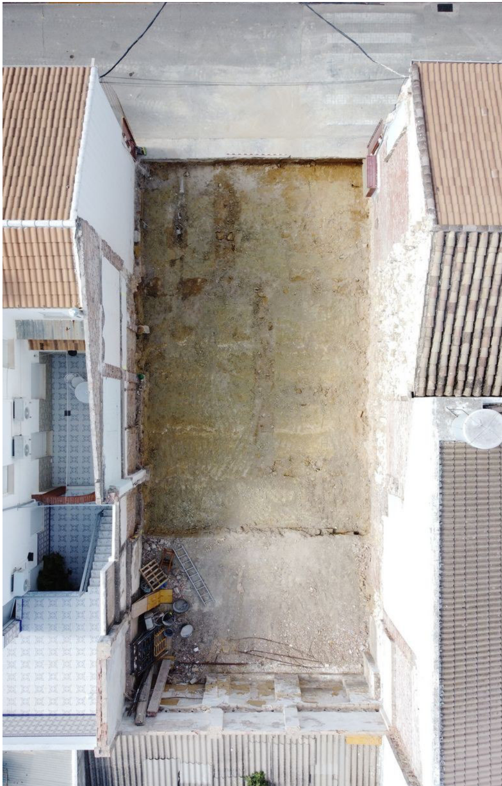
Fig. 9. Fotografía cenital de la planta final de la intervención, con los niveles geológicos y los fondos de las cimentaciones de la vivienda contemporánea demolida, y líneas de saneamiento. Fuente: Fototeca de ARQVIPO. Sign. FD-2021-06-03-ND610-047.
