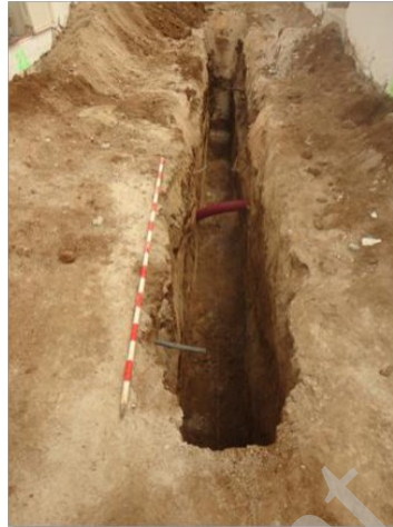
Lám. II. Calle Coín. Vista desde el este de zanja para la inserción de los tubos desaneamiento.
