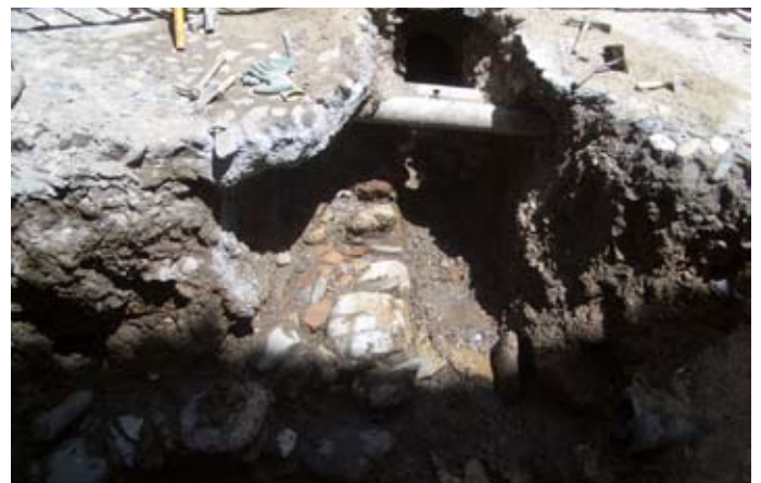
Perspectiva de la salida de la acometida de la casa. Pozo de piedra bajo la acometida.
