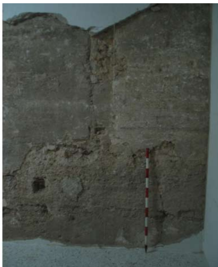
Figura 4. Habitación 1: La muralla apareció cubierta por una gruesa capa de cemento y una malla metálica. Abajo detalle de la reparaciones en ladrillo.
