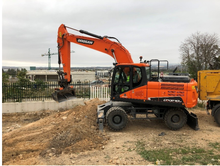
Fig.3 Ejecución de los trabajos. Nueva Estación de Alta Velocidad en el fondo.
