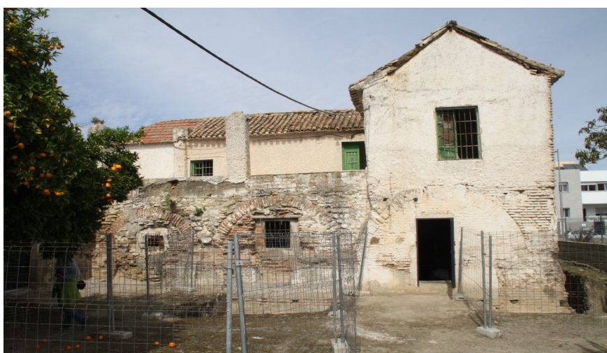
Lámina 1. Frente sur de los baños de Churriana con el cuerpo morisco sobre él
