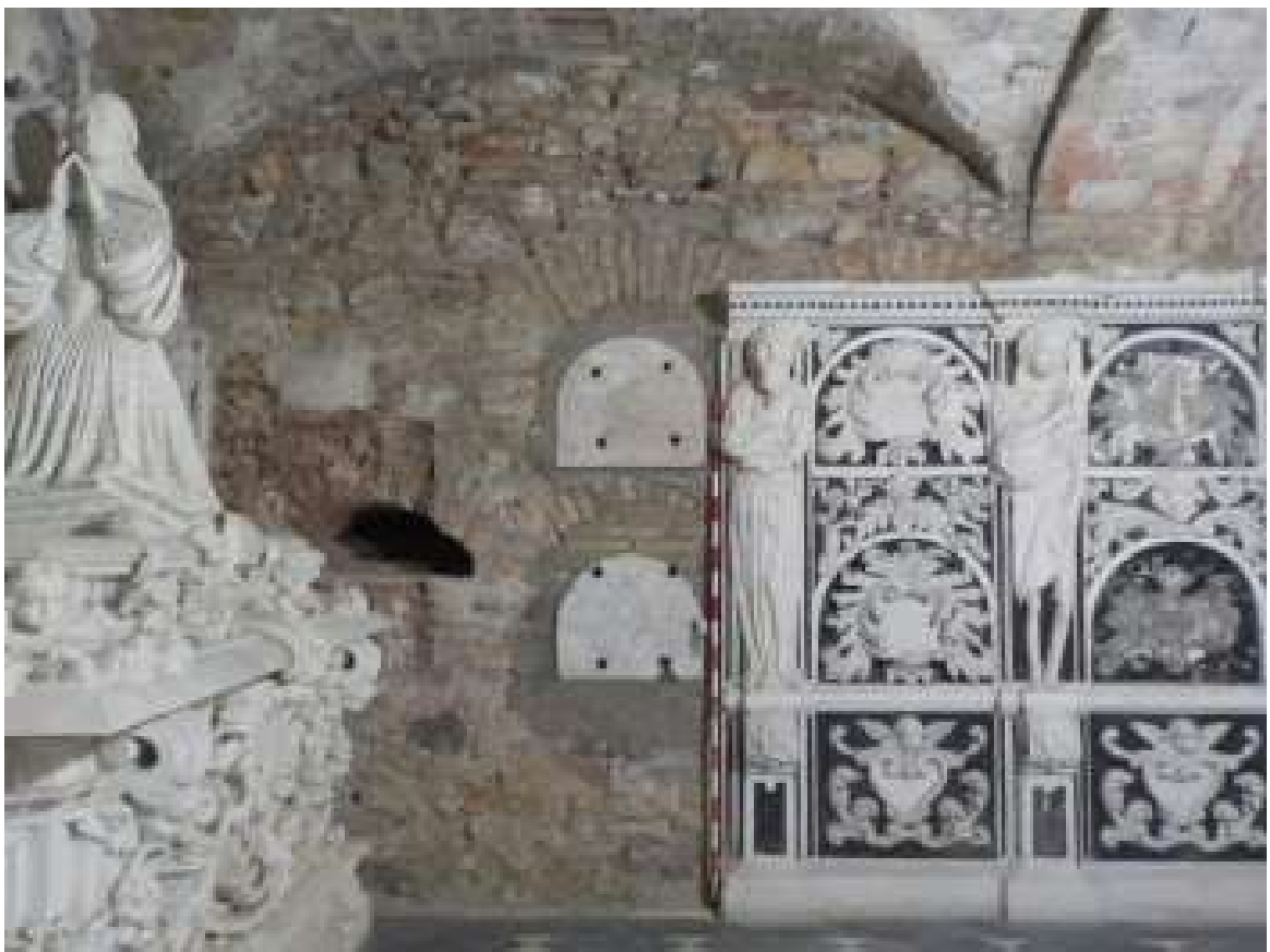
Lám.1: Estado final de las actuaciones en el lienzo noroeste de la Cripta de los Condes de Buenavista.
