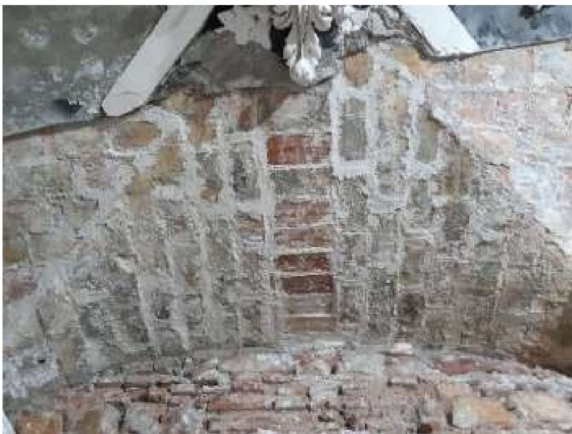
Lám. 2: Estado final de las actuaciones en la bóveda de arista de la Cripta de los Condesde Buenavista.
