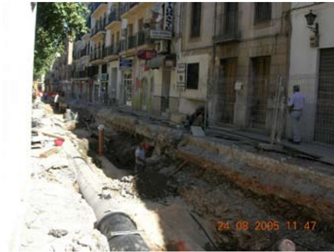
Perspectiva de la excavación en el último tramo de la obra. Ver la profundidad de las tuberías.
