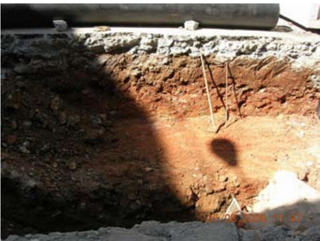
Excavación para acometida en la que apareció la estructura de ladrillo que podría ser de un horno.
