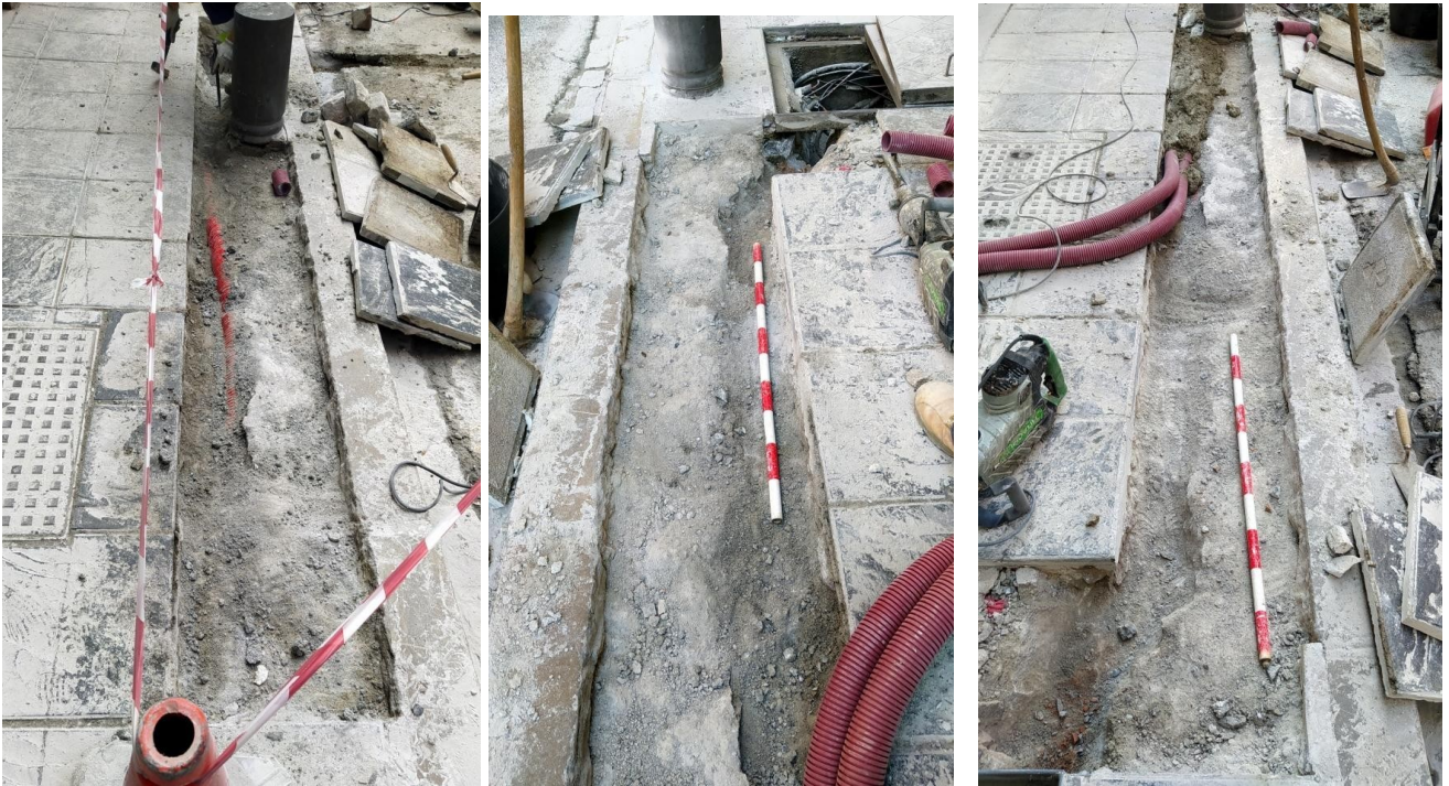
Ilustración 16: Zanja en la acera Este de la calle, con otros servicios paralelos.
