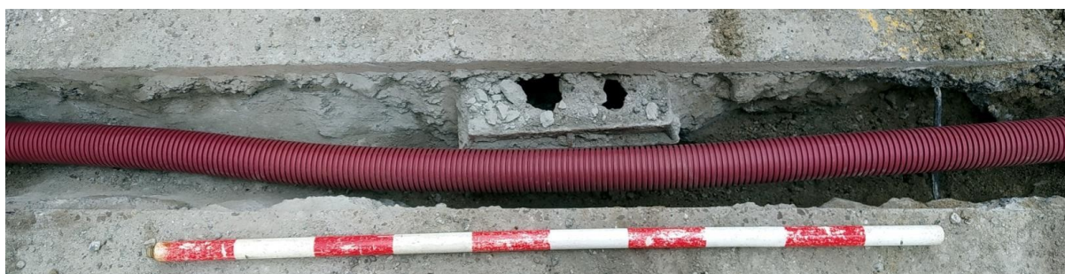
Ilustración 14: Imbornal bajo el asfalto y zanja en acera Este.
