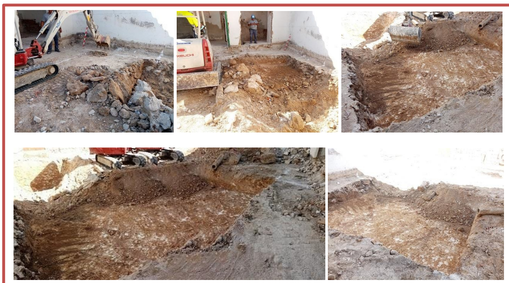
FIG. 10. VACIADO DE LOS DOS PRIMEROS METROS MÁS MERIDIONALES DEL ÁREA DESTINADA A LA PLAYA Y ESCALERAS DE LA PISCINA PROYECTADA: AFLORAMIENTO DE LA MATRIZ GEOLOGICA DEL TERRENO DESDE COTAS MUY SUPERFICIALES (Fotos: Rafael Sánchez).
