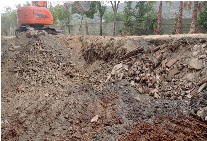
Lám. IV – Depósitos de escombros en el sector central.
