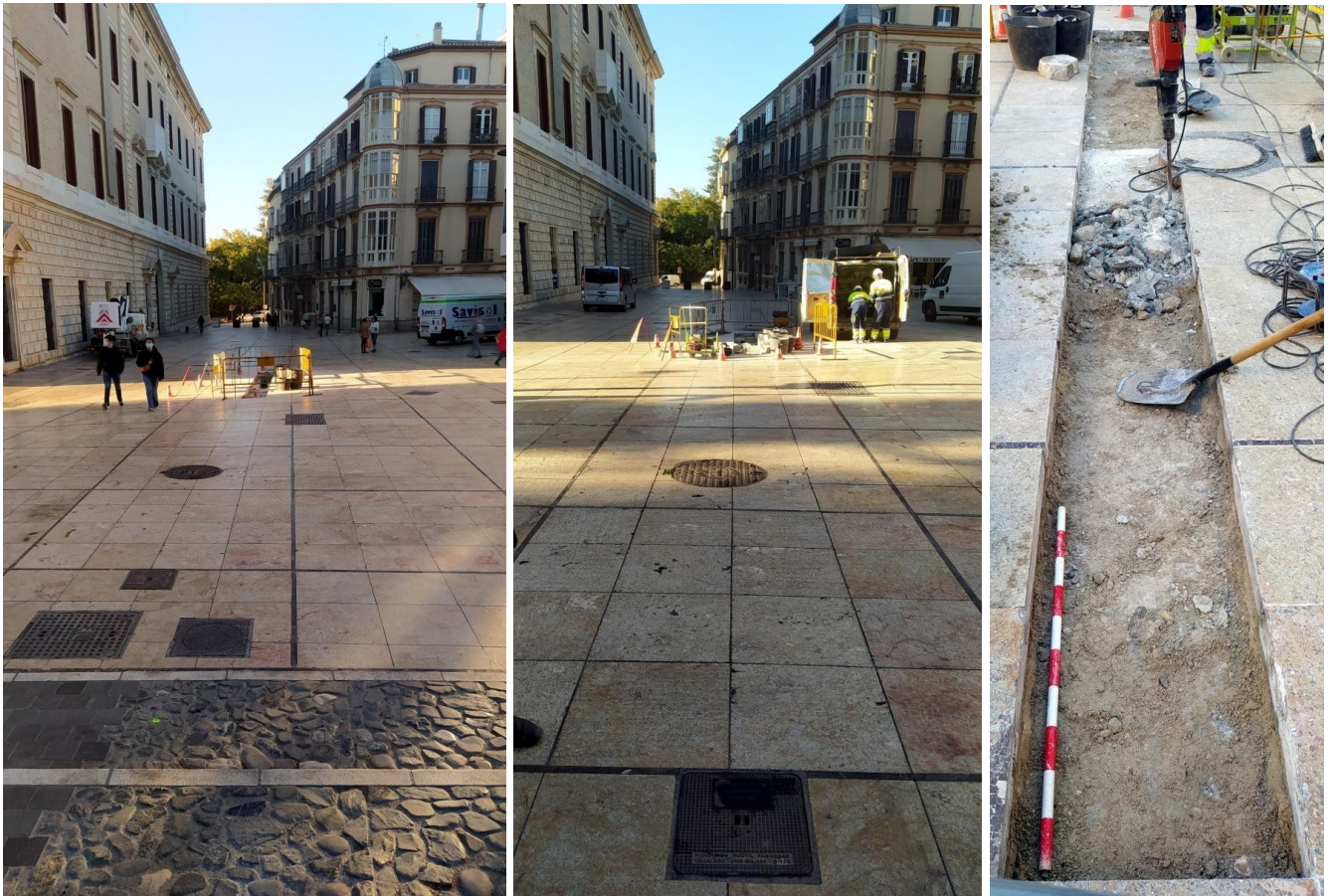
Ilustración 7: Levantamiento de las losas del pavimento en el primer tramo de la Zanja1.
