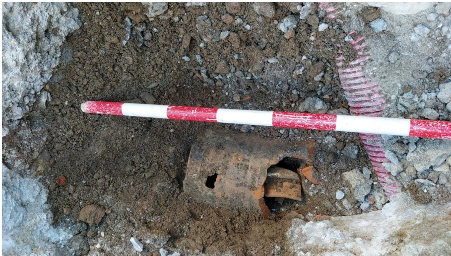
Ilustración 14: La tubería de atanores continúa bajo los corrugados rojos
