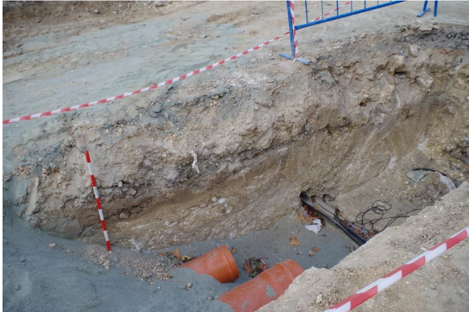
Fig. 2. Detalle de una de las zanjas abiertas en el eje de la calle con la inserción de las tuberías de pluviales y fecales. Se observa el geológico a 0,50 m desde la rasante.
