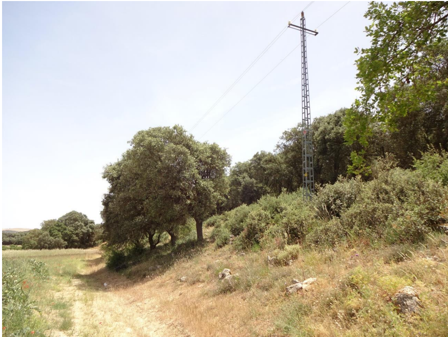
Detalle de parte de la línea a desmontar, sobre la que se superpone la nueva línea
