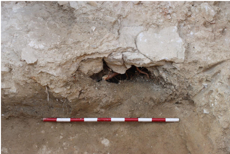
Figura 23. Detalle de surgencia de agua bajo el mismo nivel de cimentación.
