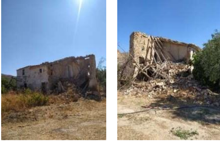
Ilustración 9. Casas en ruinas.
