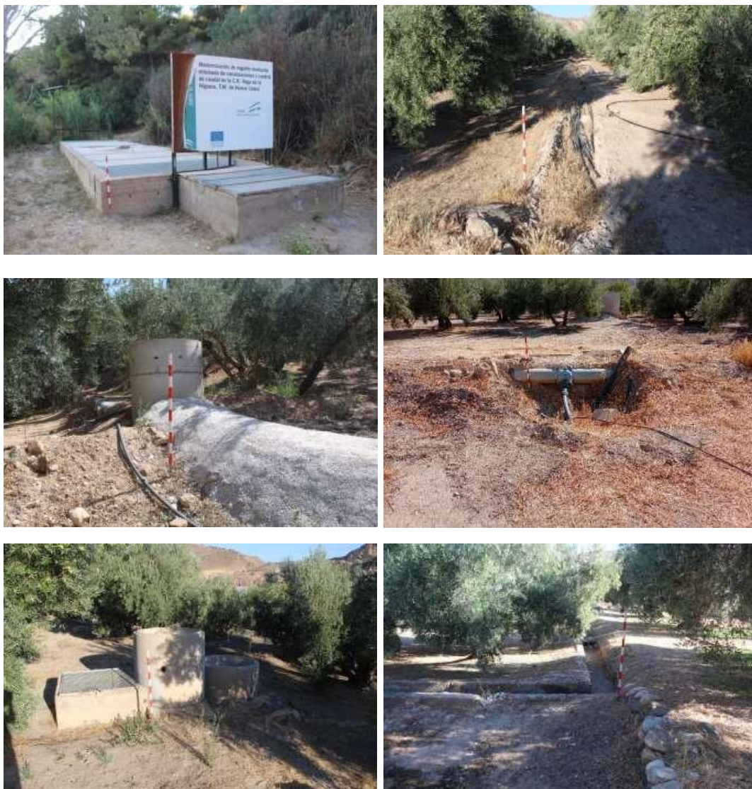
Ilustración 6. Sistemas de riego ya existentes en la zona de estudio.
