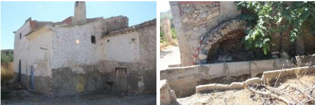
Ilustración 10. Vivienda derrumbada con horno.
