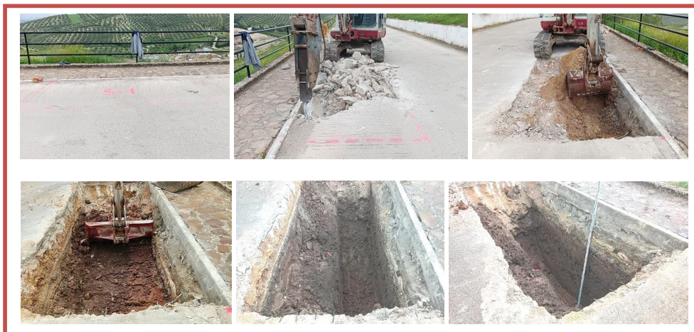
FIG. 7. IMÁGENES DEL PLANTEAMIENTO Y EJECUCIÓN DEL PROCESO DE EXCAVACIÓN, CON MEDIOS MECÁNICOS, DEL SONDEO Nº 1 EN EL DENOMINADO “SECTOR SEPTENTRIONAL” DE INTERVENCIÓN ARQUEOLÓGICA, DENTRO DEL VIAL DE LA C/ MOLINO MEDEL DE MARTOS (JAÉN). Fotos: Rafael Sánchez Susí.
