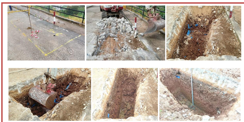
FIG. 12. IMÁGENES DEL PLANTEAMIENTO Y EJECUCIÓN DEL PROCESO DE EXCAVACIÓN, CON MEDIOS MECÁNICOS, DEL SONDEO Nº 6 EN EL DENOMINADO "SECTOR ORIENTAL" DE INTERVENCIÓN ARQUEOLÓGICA, DENTRO DEL VIAL DE LA C/. MOLINO MEDEL DE MARTOS (JAÉN). Fotos: Rafael Sánchez Susi.
