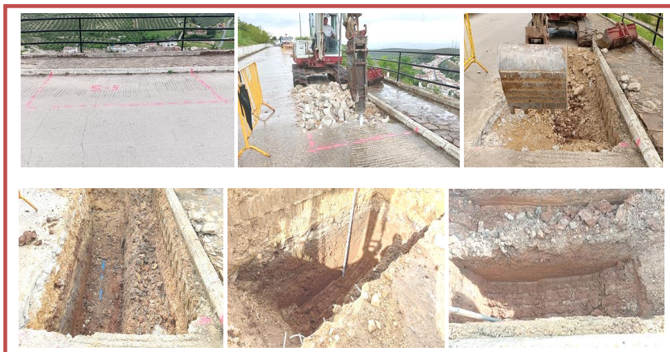
FIG. 9. IMÁGENES DEL PLANTEAMIENTO Y EJECUCIÓN DEL PROCESO DE EXCAVACIÓN, CON MEDIOS MECÁNICOS, DEL SONDEO Nº 3 EN EL DENOMINADO "SECTOR SEPTENTRIONAL" DE INTERVENCIÓN ARQUEOLÓGICA, DENTRO DEL VIAL DE LA C/. MOLINO MEDEL DE MARTOS (JAÉN). Fotos: Rafael Sánchez Susí.
