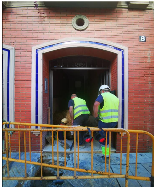
Fig. 5. Detalle fotográfico del inmueble n° 8 de la calle Paseo de la Independencia, afectado por las obras.
