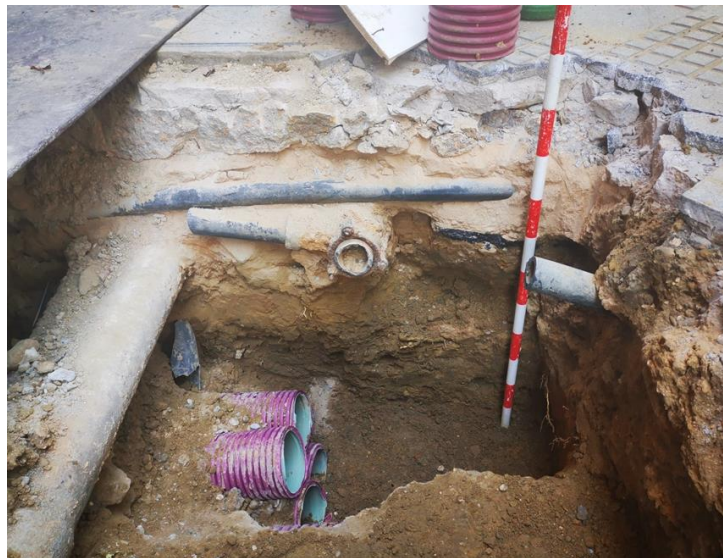
6.1. Ampliación de la anchura en este tramo para la introducción de 4 tubos nuevos para la electricidad.
