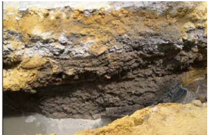
Calle San Pablo. Perfil Sur Zanja 2 Se refleja la sucesión de estratos contemporáneos y los rellenos de colmatación, así una tubería de agua antigua.
