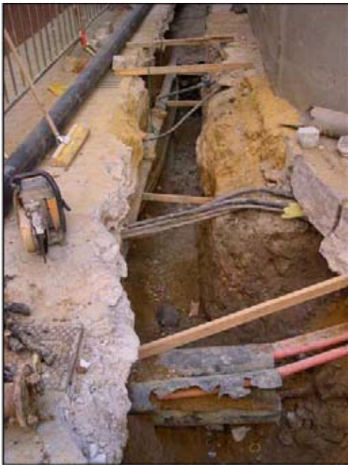
Vemos en la imagen la cantidad de cable eléctricos que cruzan la zanja.
