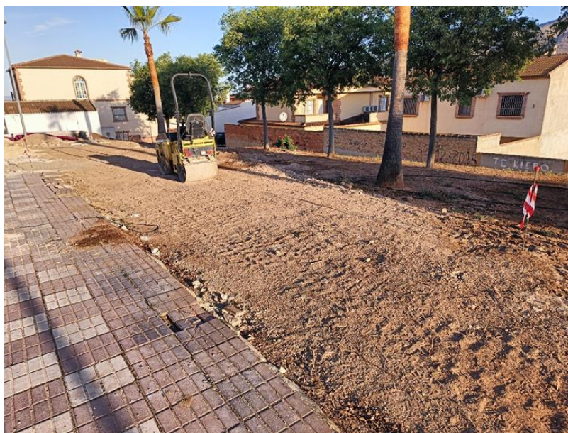
Fig. 3. Zona de raspado del terreno en el sector norte de la plaza.
