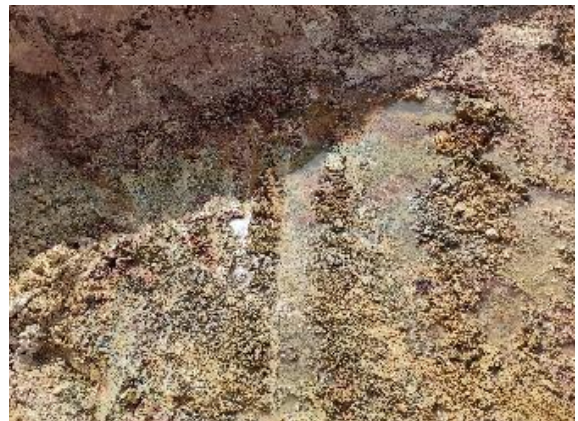
Foto 22. Planta 3. Detalle aparición nivel geológico con floración de agua
