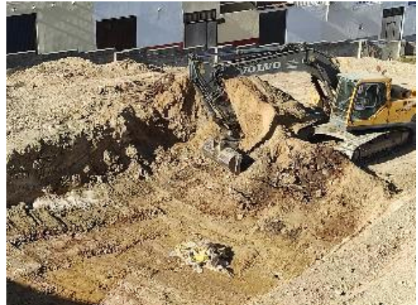
Foto 60. Amontonamiento de plásticos y hierros de verja en la planta final del sondeo 3.
