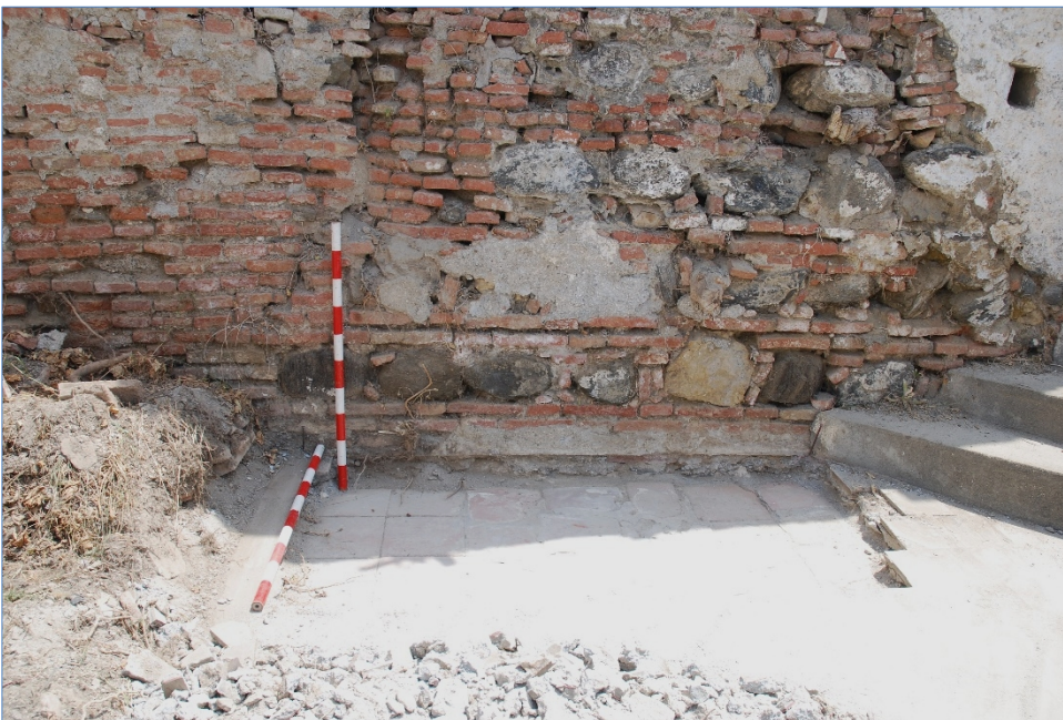
Fig. 5. Detalle de los sistemas constructivos que componen la arquitectura de la torre, en la base de esta.
