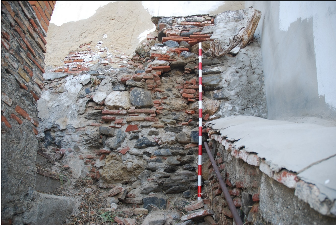
Fig. 9. Detalle del aparejo del muro medianero al noreste, una amalgama muy rudimentaria de piezas de mampostería y ladrillos.
