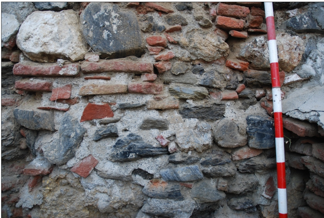
Fig. 10. Detalle de los morteros que traban el paramento de las partes más antiguas de E-1. Destaca el empleo de argamasa en las yagas, mientras que las piezas están tomadas con morteros de tierra.
