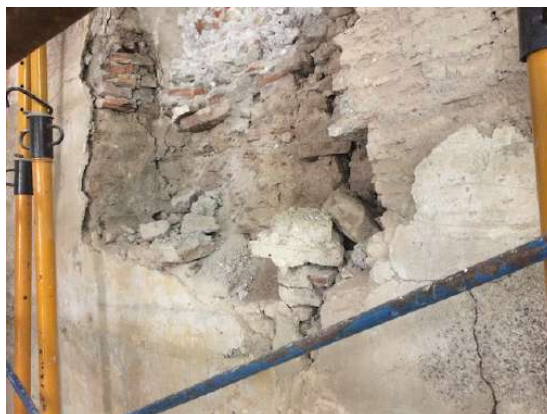
Fig. 3 Presencia de doble paramento.
