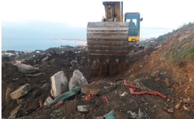
Láminas 4. Detalle de los escombros localizados
