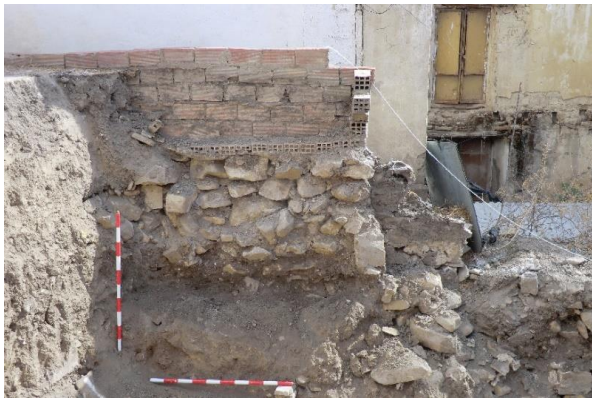
Foto 62. Aparición de UE 8 previamente a su desplome.
