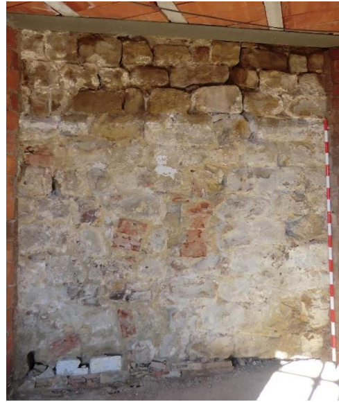
Foto 31. Muralla con la capa de yeso pintura retirada. Aparición de ladrillos y cemento cubriendo huecos
