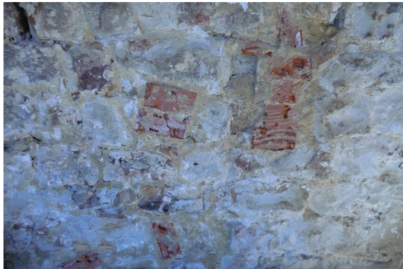
Foto 32. Detalle de ladrillos y cemento cubriendo huecos
