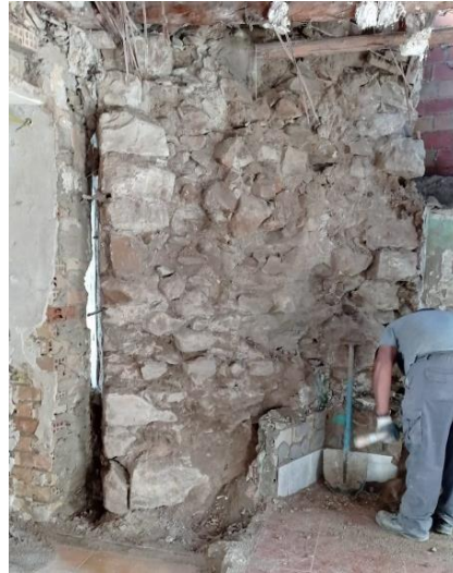
Foto 37. Limpieza tramo 3 muralla. Interior muralla. Cara no vista
