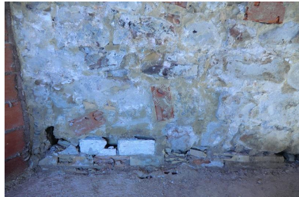
Foto 33. Detalle de ladrillos y cemento cubriendo huecos
