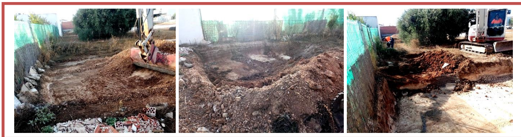
FIG. 8. PROCESO DE C.A.M.T. EN LA ZONA DEL FONDO DEL SOLAR (ZONA ORIENTAL DEL MISMO) DESTINADA A LA CONSTRUCCIÓN DE LA PISCINA PROYECTADA (Fotos: J.A. Hermoso).
