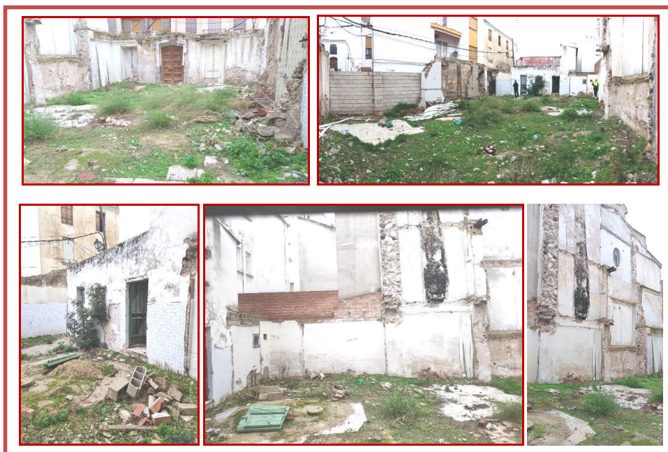
FIG. 11. ESTADO PREVIO DEL SOLAR. ARRIBA: FOTOS DESDE LOS FONDOS DEL SOLAR ESTE Y OESTE; ABAJO IZQU.: PEQUEÑAS HABITACIONES SIN DEMOLER EN EL FONDO ORIENTAL DEL SOLAR; ABAJO CENTRO E IZQU.: PARED MEDIANERA MERIDIONAL QUE NO SE VA A DEMOLER POR PRESCRIPCIÓN DE LA DIRECCIÓN FACULTATIVA DE LAS OBRAS (Fotos: JUAN ÁNGEL MARTOS HERMOSO).
