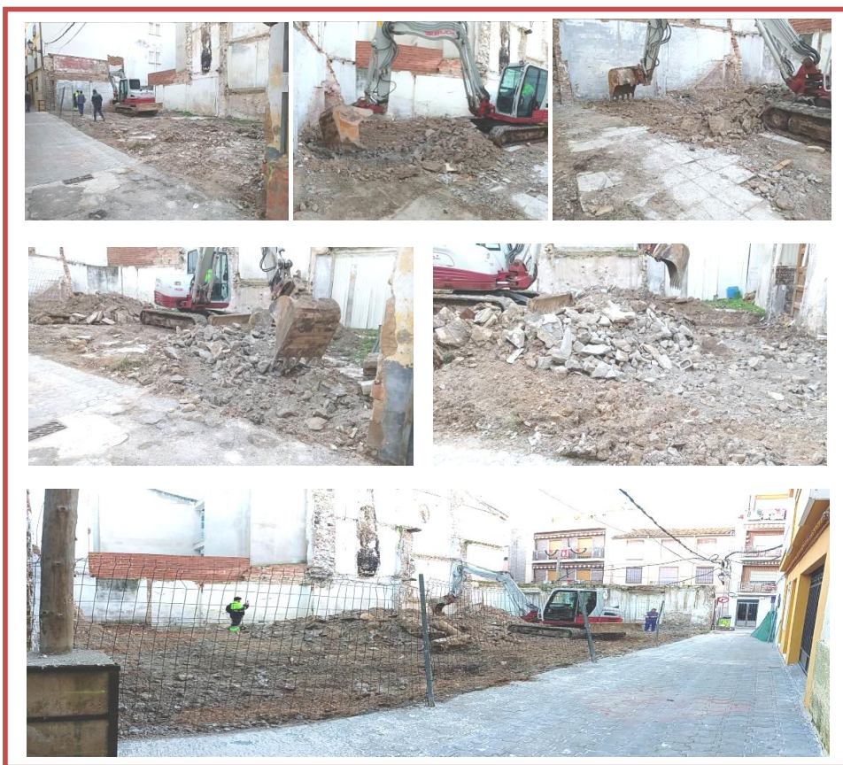
FIG. 13. PROCESO DE DERRIBO Y DESESCOMBRO DE LA PARED DE FACHADA DE LA C/. SALSIPUEDES Y DE LAS PEQUEÑAS HABITACIONES EXISTENTES EN EL FONDO ORIENTAL DEL SOLAR (Fotos: JUAN ÁNGEL MARTOS HERMOSO).
