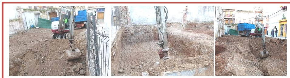
FIG. 16. CONTINUACIÓN DE LOS PROCESOS DE VACIADO DE LA ZONA CENTRO-SEPTENTRIONAL DEL SOLAR HASTA LAS COTAS NECESARIAS PARA LA IMPLANTACIÓN DE LA NUEVA CIMENTACIÓN PROYECTADA (FOTOS: JUAN ÁNGEL MARTOS HERMOSO).
