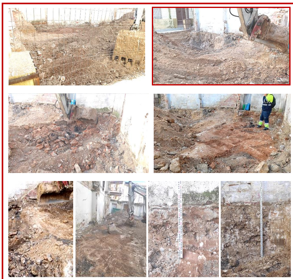
FIG. 14. PROCESO DE VACIADO DE LA ZONA ORIENTAL DEL SOLAR = ARRIBA: VACIADO DE LOS ESCOMBROS (U.E.N. 1) DE COLMATACIÓN Y SELLADO DE UN POSIBLE ARROYADERO/CANAL DE DRENAJE HIDRÁULICO NATURAL (U.E.N. 2) EN LA ZONA SURORIENTAL DEL SOLAR; CENTRO: ELIMINACIÓN DE LA RED DE SANEAMIENTO INTERIOR DEL ANTIGUO EDIFICIO DERRIBADO Y AFLORAMIENTOS DEL PRIMER ESTRATO DE LA MATRIZ GEOLÓGICA DEL TERRENO; ABAJO: AFLORAMIENTOS DE LA MARIZ GEOLÓGICA DEL TERRENO Y CONTRASTE EN PERFIL DE LA INTERFACIES DE ESE ARROYADERO/CANAL DE DRENAJE (U.E.N. 2) RESPECTO AL PAQUETE ARTIFICIAL DE ESCOMBROS QUE LA COLMATA Y SELLA (U.E.N. 1). FOTOS: JUAN ÁNGEL MARTOS HERMOSO.
