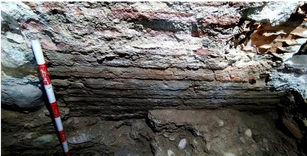
Ilustración 11: Restos de muro de un edificio anterior incluido en el alzado actual.
