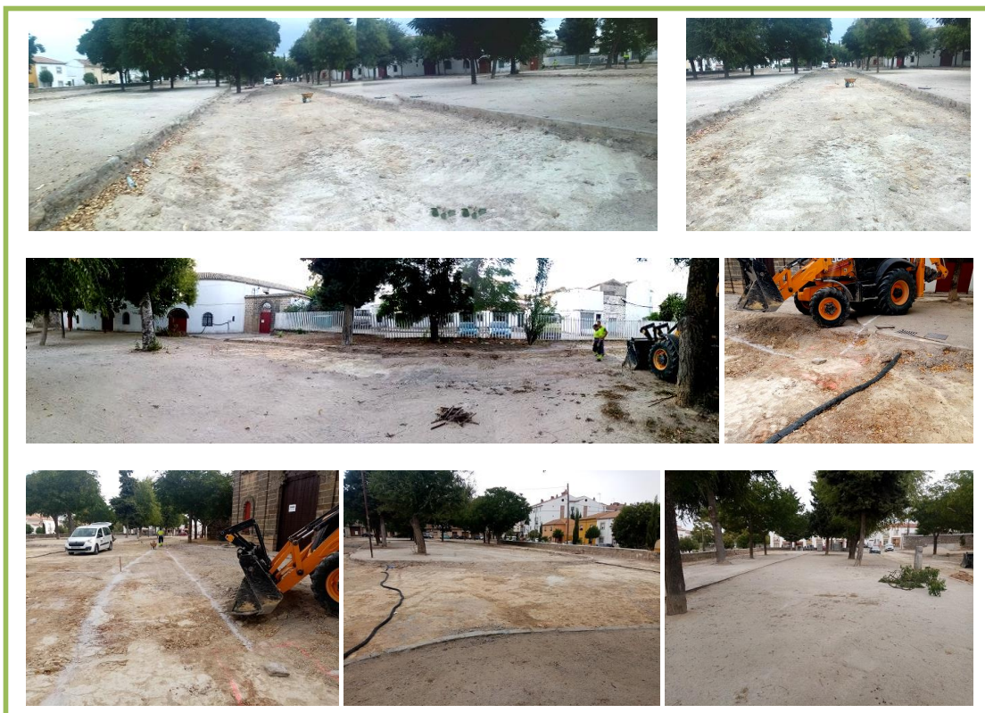
FIG. 5. ESTADO PREVIO GENERAL AL INICIO DE NUESTRA INTERVENCIÓN ARQUEOLÓGICA MEDIANTE C.A.M.T., DONDE PODEMOS OBSERVAR QUE YA SE HABÍAN ELIMINADO CON MEDIOS MECÁNICOS LAS SOLERÍA Y SOLERAS ANTIGUAS EN UNOS 30 CMS. DE ALTURA DESDE LAS RASANTES DE LOS ACERADOS EXISTENTES EN TODO EL ENTORNO DE LA PLAZA DE TOROS (Fotos: Rafael Sánchez).
