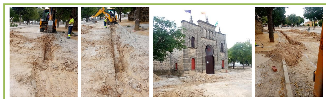
FIG. 8. APERTURA DEL SEGUNDO TRAMO DE LA ZANJA PRINCIPAL HASTA LA INTERSECCIÓN CON LA TERCERA DE LAS ZANJAS LATERALES, DONDE EL BANCO DE ROCA NATURAL BUZABA EN PENDIENTE HACIA EL NORESTE (Fotos: Rafael Sánchez).
