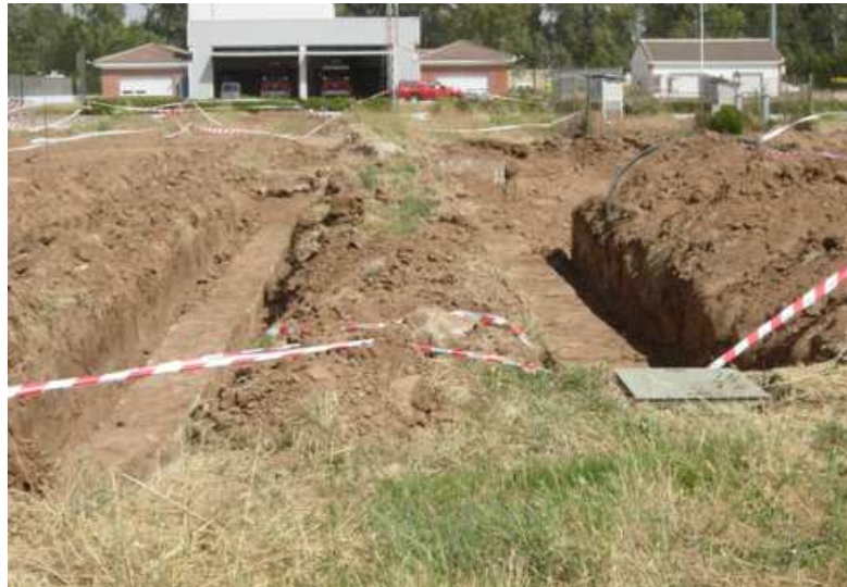
Lámina II. Canalizaciones 1 (U.e.3) y 2 (U.e.6)
