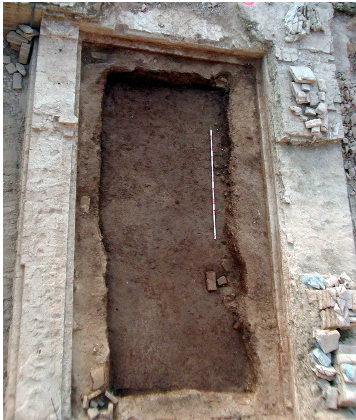
Lámina VI. Seguimiento 6. Cimentaciones y zanja de cimentación de la sala de conexión entre la galería este del claustro principal y la galería oeste del claustro de Levante.
