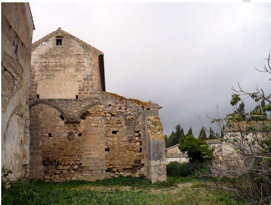
Lám. IX. Ubicación del Corte 4, en el encuentro entre las crujías norte y este.
