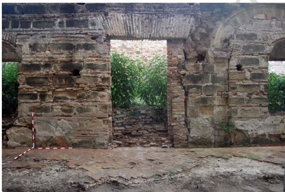
Lám. IV. Imagen de la galería de la celda V, con restos de la solería UE 5 y el muro de fachada UE 300.
