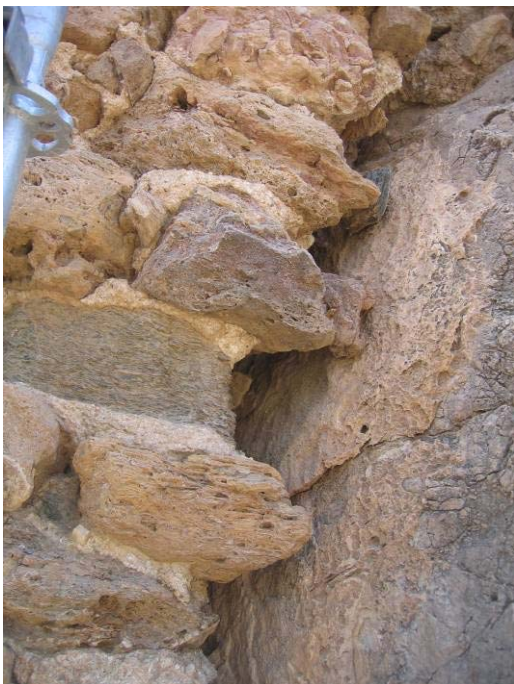
Detalle del apoyo de la cimentación del E-14 en la roca. Como la mayor parte de los lienzos que conforman el castillo, apoyan directamente en roca, en este caso el mismo alzado del muro E-14.
