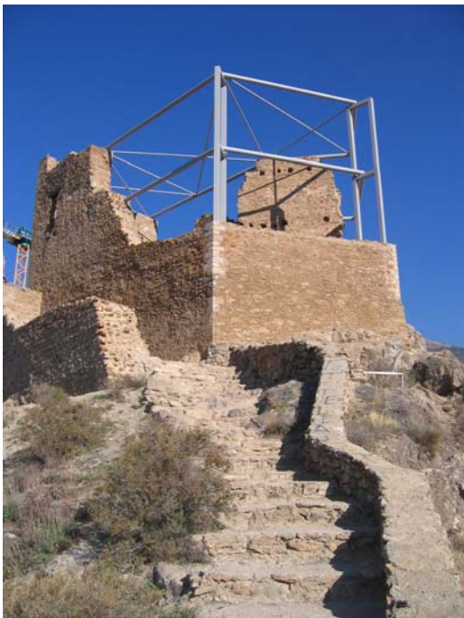
Vista panorámica de la torre del homenaje una vez finalizados los trabajos.
