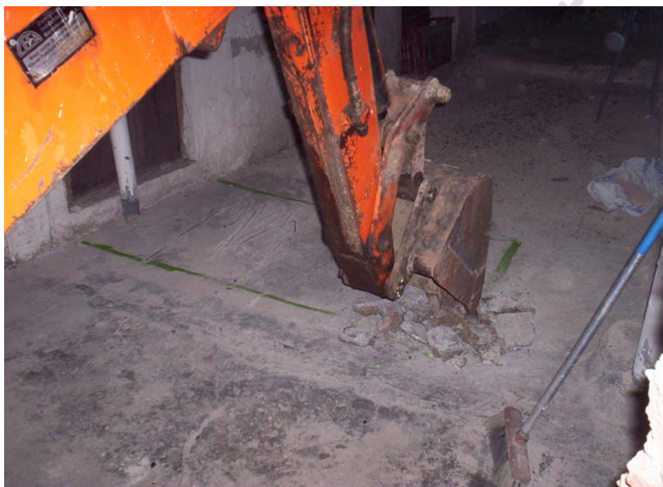
Detalle de la actividad de rebaje mecánico del hueco de la escalera.
