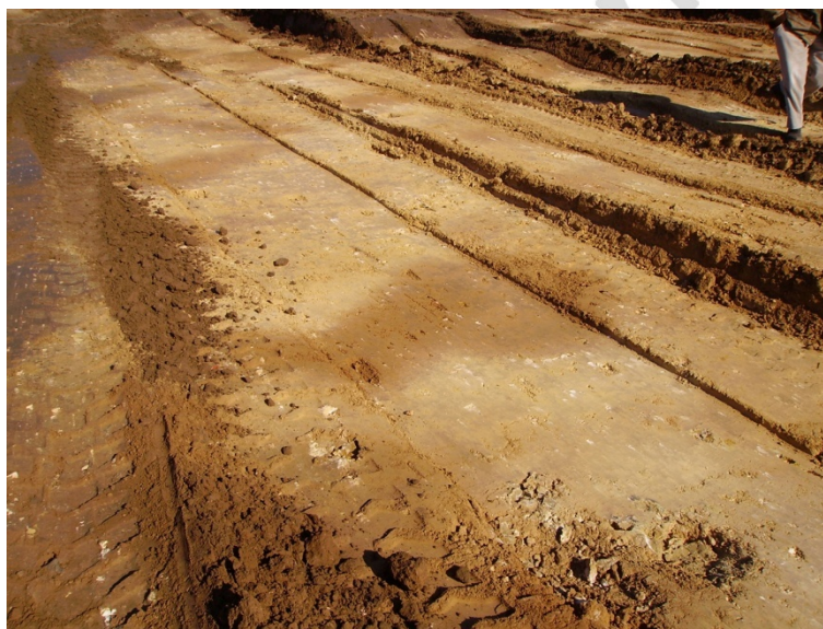
Lam 4: Margas amarillas-anaranjadas y manchas de humedad
