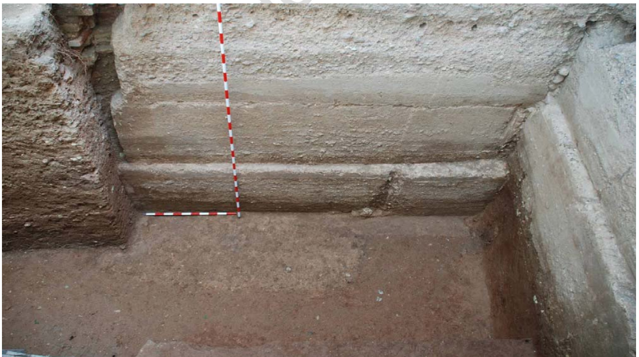
Figura 8. Vista general del basamento de la Torre 3. A la derecha se sitúa la zapata de cimentación de la muralla.
