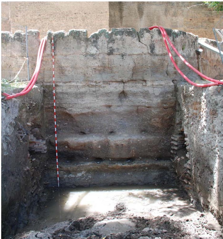
Figura 5. Vista del Corte 3 en el que se aprecia el alzado exterior erosionado de la barbicana.
