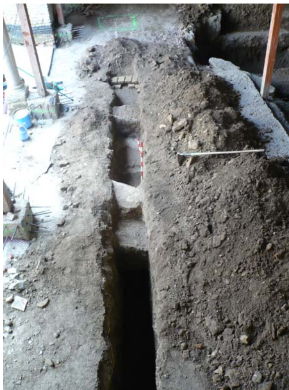
Figura 16. Vista del desarrollo de las zanjas, así como la ubicación de las arquetas.
