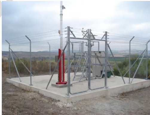
Lám. 7.- Detalle de estación meteorológica, sobre losa de hormigón apoyada en la superficie del terreno. Cerro de la Molineta.
