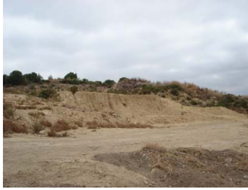
Lám. 8.- Movimientos de tierra en la ladera sur del cerro para extracción de áridos. Por lo demás existe un camino de acceso en la ladera W. El resto del cerro presenta vegetación de matorral.
