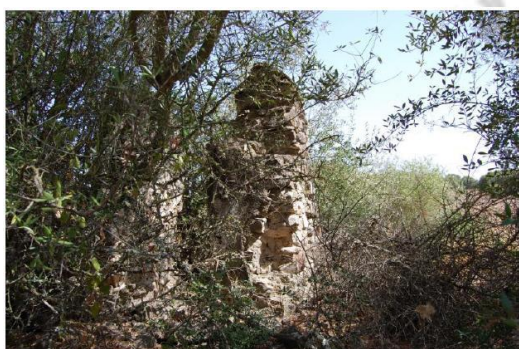
Foto 6. Camino 2º. Tramo C. Restos de Vivienda Rural y Detalle del Alzado del Muro.
