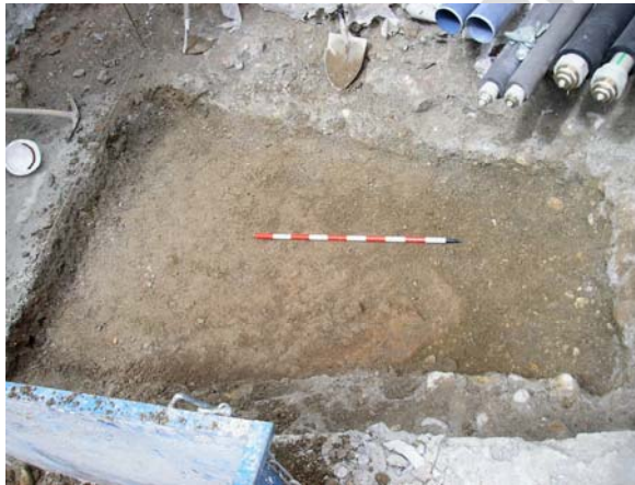
Lam IV: Vista general de la cimentación, área de excavación acotada y reducida por la misma.
