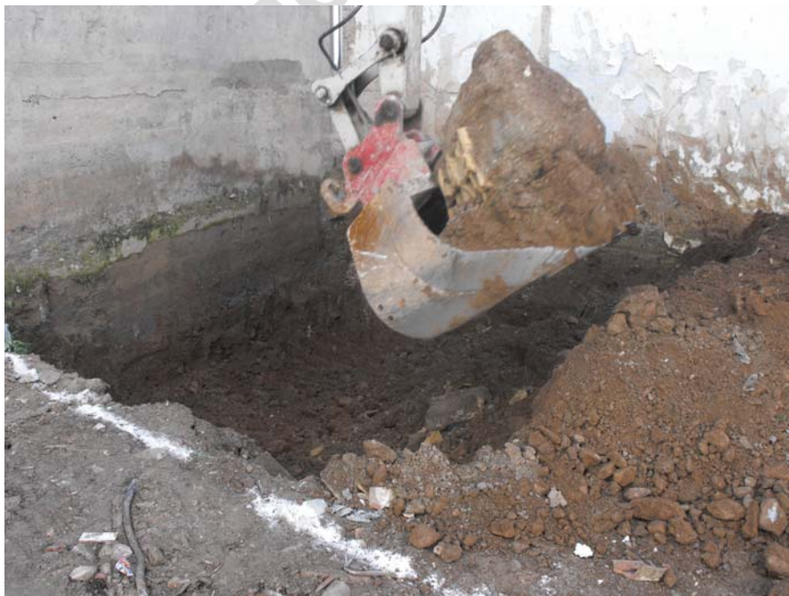
Lam. 2. Inicio del movimiento de tierras en la zona Sureste del solar
