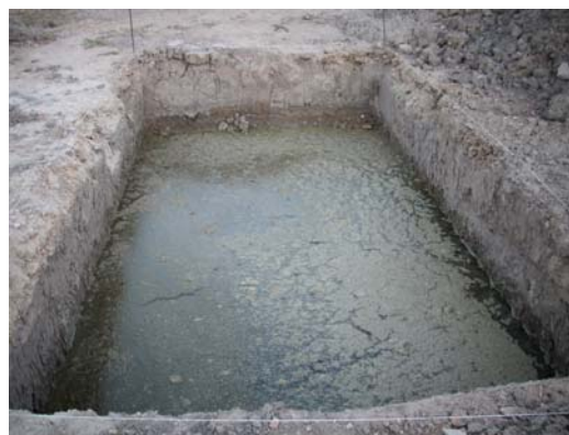
Lám. II: Vista del sondeo 1 anegado
